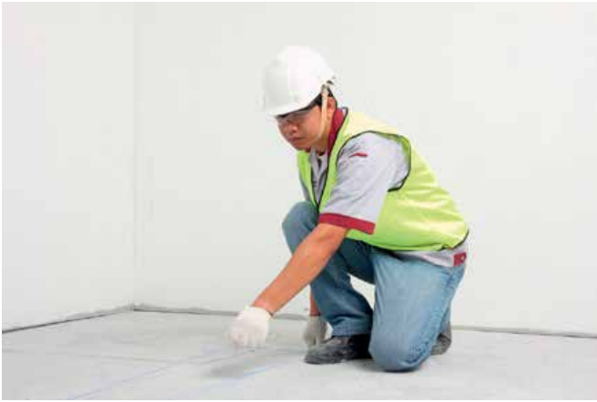
1 กำหนดแนวของผนังไว้ที่พื้นและเพดาน โดยใช้ดิ่งหรือบรรทัดระดับ ตีแนวไว้ที่พื้นและเพดาน
